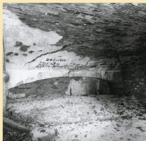
Praskliny ve stropních klenbách (Foto HBZS Ostrava, Magistrát města Karviná)
