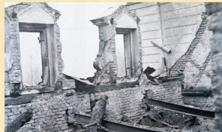
Výhořelá mansardová část zámku obývaná Wehrmachtem. Intenzitu požáru dokládá stav ocelových nosníků (Foto z pozůstalosti F. Sikory)
