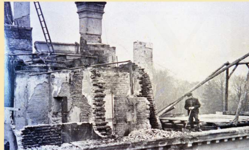
Stav střechy po požáru. V pravé části fotografie lze spatřit dřevěnou konstrukci vrátku a vznikající provizorní zastřešení. Jedná se o část zámku později adaptovanou na Dům zdraví. (Foto z pozůstalosti F. Sikory)
