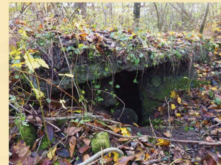
Část zavalené podzemní chodby propojující zámek Solca s domem pro služebnictvo (Foto Erika Schweserová, rok 2022)
