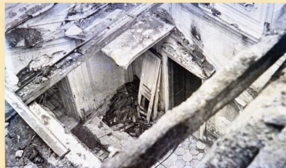
Detail poškození centrálního schodiště (Foto z pozůstalosti F. Sikory)
