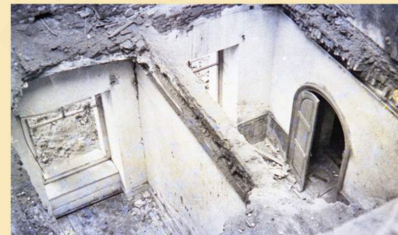
Stav stropů po požáru, pohled do přízemí (Foto z pozůstalosti F. Sikory)
