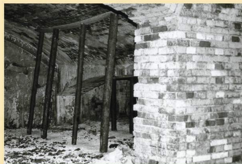
Detail provizorního zajištění objektu formou podepření stropní klenby (Foto HBZS Ostrava, Magistrát města Karviná)
