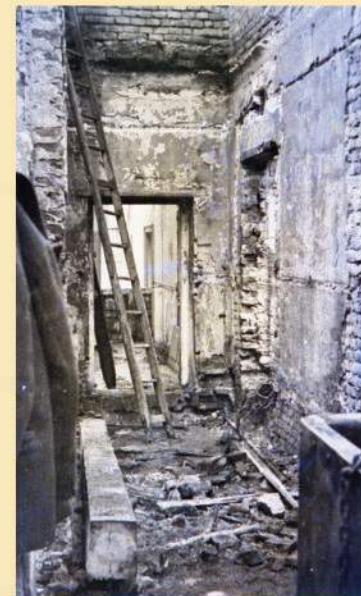
Stav zámecké chodby po požáru (Foto z pozůstalosti F. Sikory)
