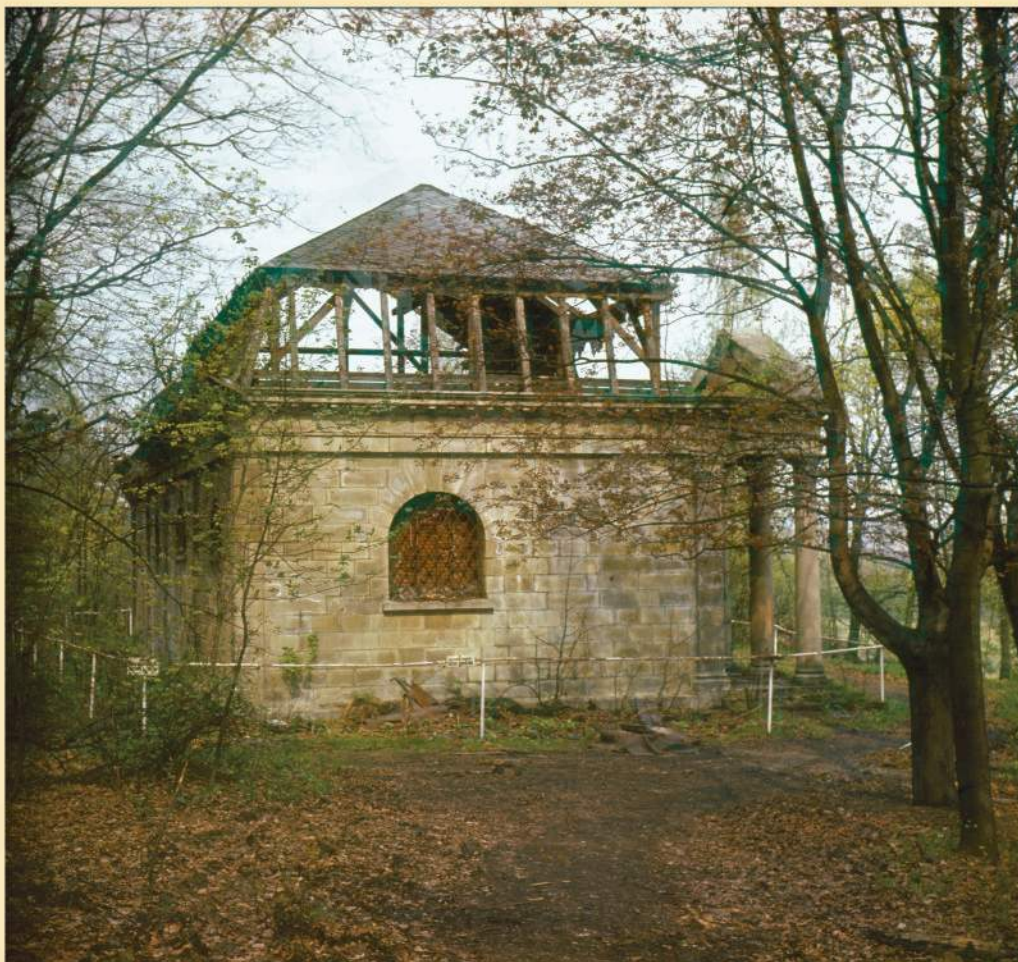
Výrazně poškozená střecha s jednoduchým ohrazením informujícím o zákazu vstupu. Konec 70. let 20. st. (Foto SOkA Karviná)
