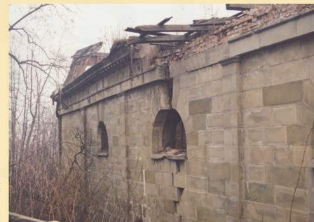
Praskliny v zadním traktu hrobky způsobené důlními vlivy. První polovina 80. let 20. st. (Foto F. Sikora, SOkA Karviná)
