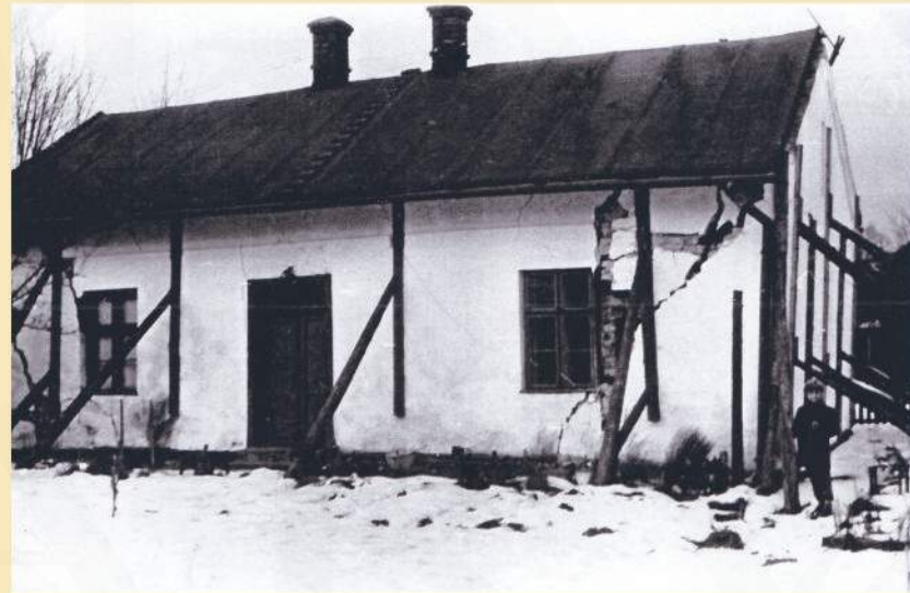
Praskliny na domě rodiny Kolatkových, č. p. 18. Dům stál na ulici Solecké v blízkosti lázní Jodosol (Foto ze soukromé sbírky Zdeňka Janulka)
