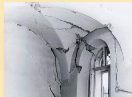
Trhliny ve zdivu a stropních klenbách způsobené důlními vlivy. Rok 1941 (Foto Sigfried Kipper, SOkA Karviná)
