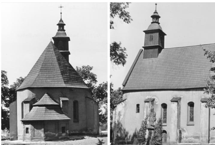
Kostel sv. Jošta v roce 1963 s patrnými stopami zavlhlého zdiva
